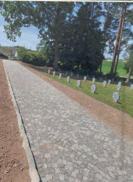
Pflasterungsarbeiten durch die Deutsche Bundeswehr am Soldatenfriedhof Freistadt-Jaunitzbachtal und der neu gepflasterte seitliche Zugangsweg
