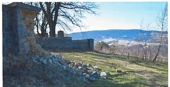
Schwere Schäden an der Einfriedungsmauer des Kriegerfriedhofes Nr. 80 Sękowa im April 2021 Bildquelle: Mag. Krzysztof Garduła, Krakau
