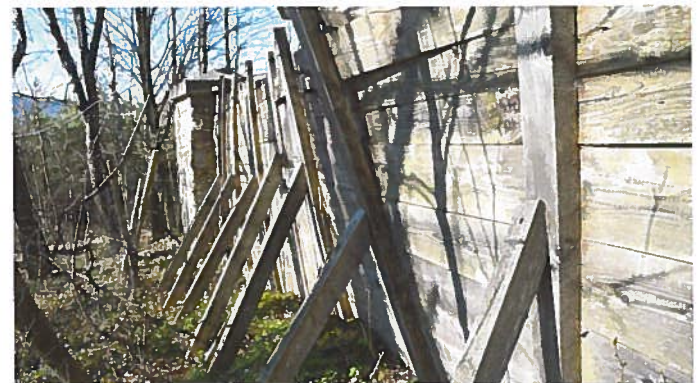
Abstützung der schwer beschädigten Einfriedungsmauer des Kriegerfriedhofes Nr. 80 Sękowa im April 2021 Bildquelle: K. Garduła, Krakau
